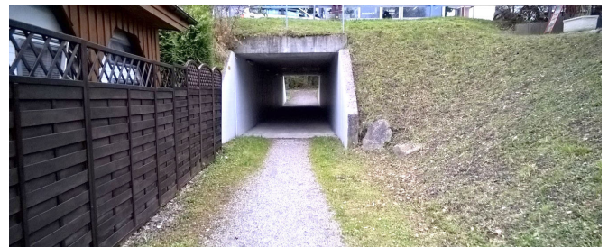
Schwachstelle bei der Unterführung des Hauptzolls: Die Unterführung ist zu schmal und nicht beleuchtet. Die Belagsübergänge sind beim Ein- und Ausgang problematisch.
